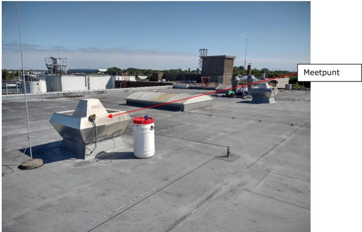
Figuur 2.2 Foto van de meetsituatie van Ruimteafzuiging gietafdeling.
